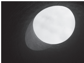
插图3, 中国-辽宁省-抚顺市, 大官屯发电所-冷却塔, 王一恒, 摄于2018年
