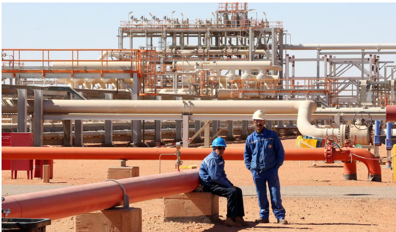
АЛЖИРСКИЕ РАБОТНИКИ ВР В ГАЗОВОМ КОМПЛЕКСЕ ТИГЕНТУРИН, В ИН-АМЕНАСЕ, 1600 КМ К ЮГО-ВОСТОКУ ОТ ГОРОДА АЛЖИР
